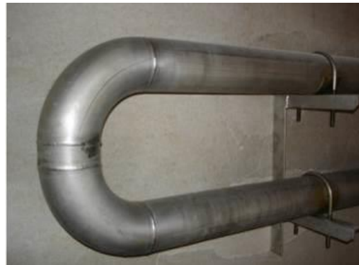
Figure 11 Serpentins de chauffage sur les digesteurs
